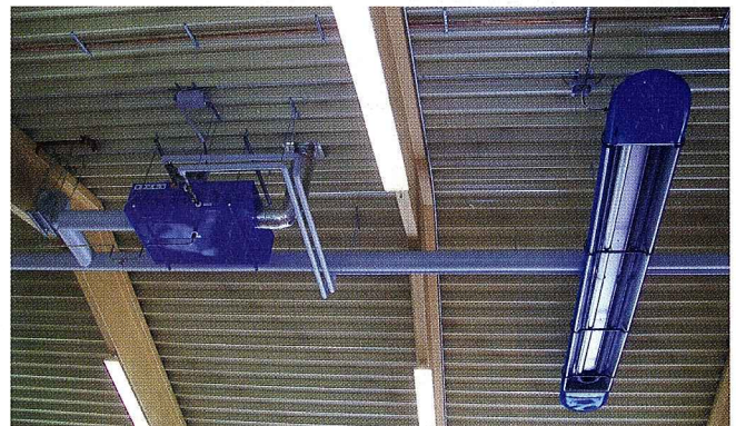
Mit Hilfe des Restwärmenutzungssystems Opus X wird Energie aus den Abgasen der Infrarotheizung genutzt.
